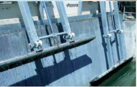
OPERA DI PRESA S. CATERINA VALFURVA (SO)
